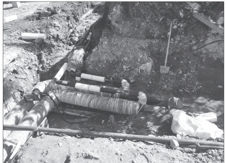
Fernheizungsanschluss Neubau Bruno Weingartner, Weihermatt.
