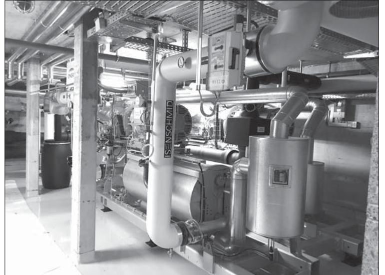
Ein Blick in die Energiezentrale im Keller des Schulhauses Sigrishofstatt.
