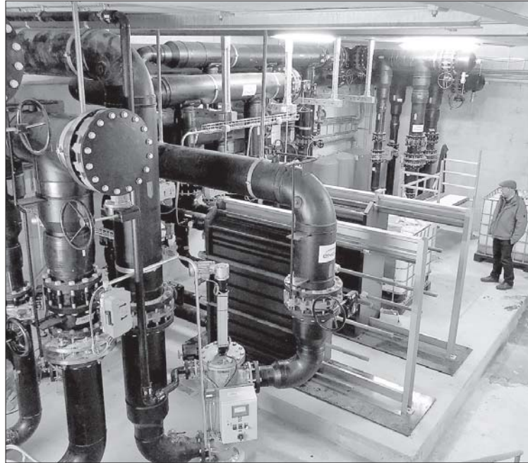
Die Korporation Weggis zeigt die Anlagen ihres Fernwärmenetzes Wärmeverbund See, hier das Pumpwerk unter dem Seespiegel.
