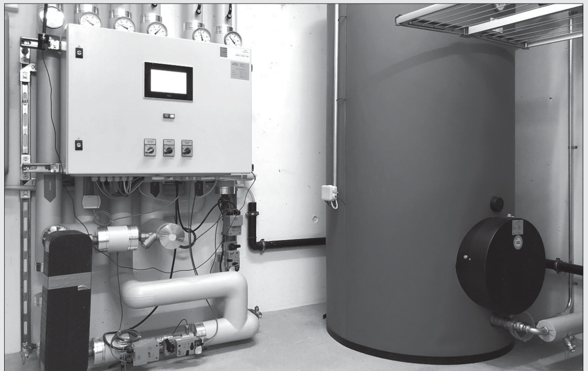
Ein Blick in den Technikraum eines Neubaus: Links die Übergabestation, rechts der Warmwasserboiler.
