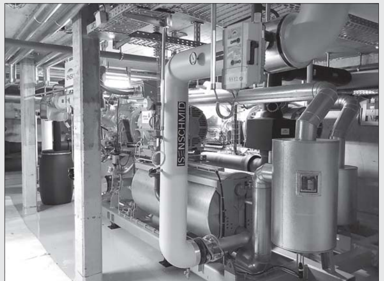
Im Keller des Schulhauses Sigrishofstatt befindet sich die Energiezentrale des Wärmeverbundes See.
