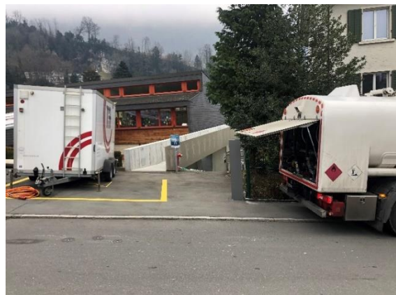
Standort mobile Notheizung beim Schulhaus Kirchmatt
