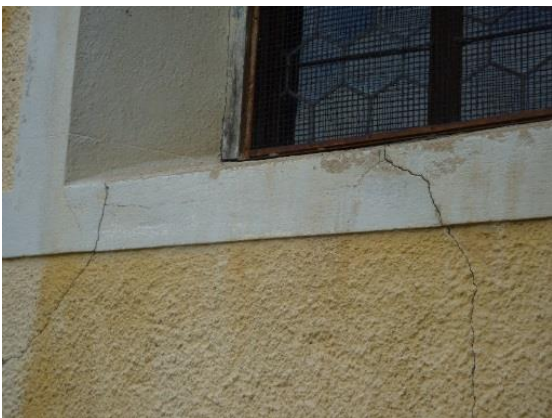
Risse im Kreuzgewölbe und an der Aussenfassade
