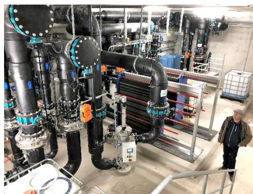
Seewasserpumpwerk Weggis: Das Pumpwerk ist seit Oktober 2018 in Betrieb und fördert ca. 9'000 m 3 Seewasser pro Stunde zur Wärmepumpe.
